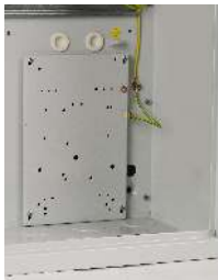
Pusta blacha montażowa
